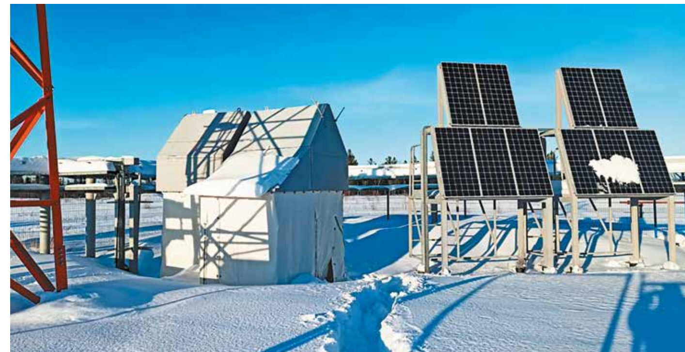
▲ Фотография объекта, на котором установлено оборудование Moxa
